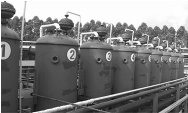
图 13 广西柳钢焦化厂焦化废水深度处理设施(树脂吸附塔)
