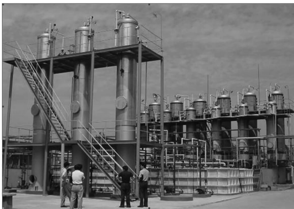
图 12 江苏淮化集团有限公司废水处理设施
